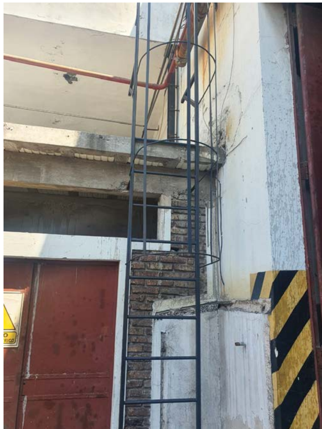
Escalera con guarda hombre a Caldera Vapor
