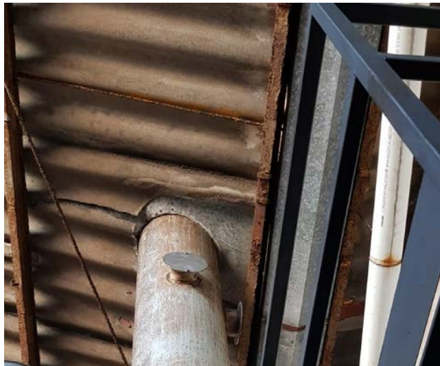
Orificios de TM de muestras. Caldera Fluido Térmico
