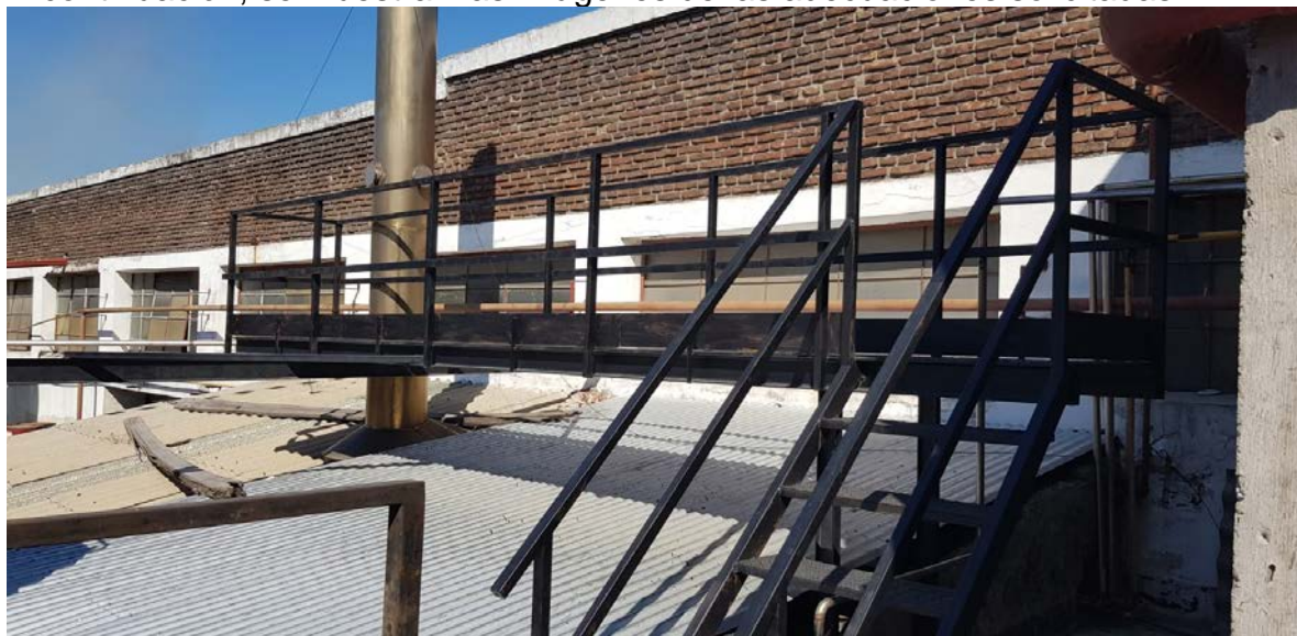
Vista de pasarela, con barandas, guardapiés y orificios de TM. Caldera Vapor
