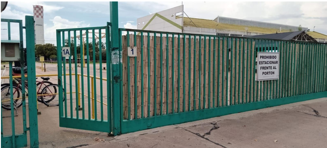
Portón de ingreso sin faja ni precinto de clausura
