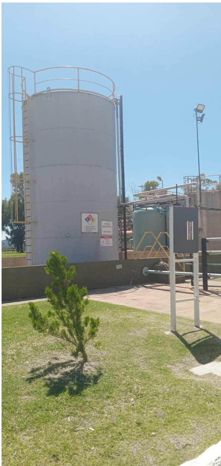
Tanque de extracción de soda caustica
