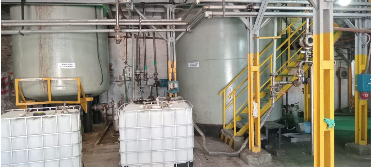
Tanque de Ester 2 DH vaciando
