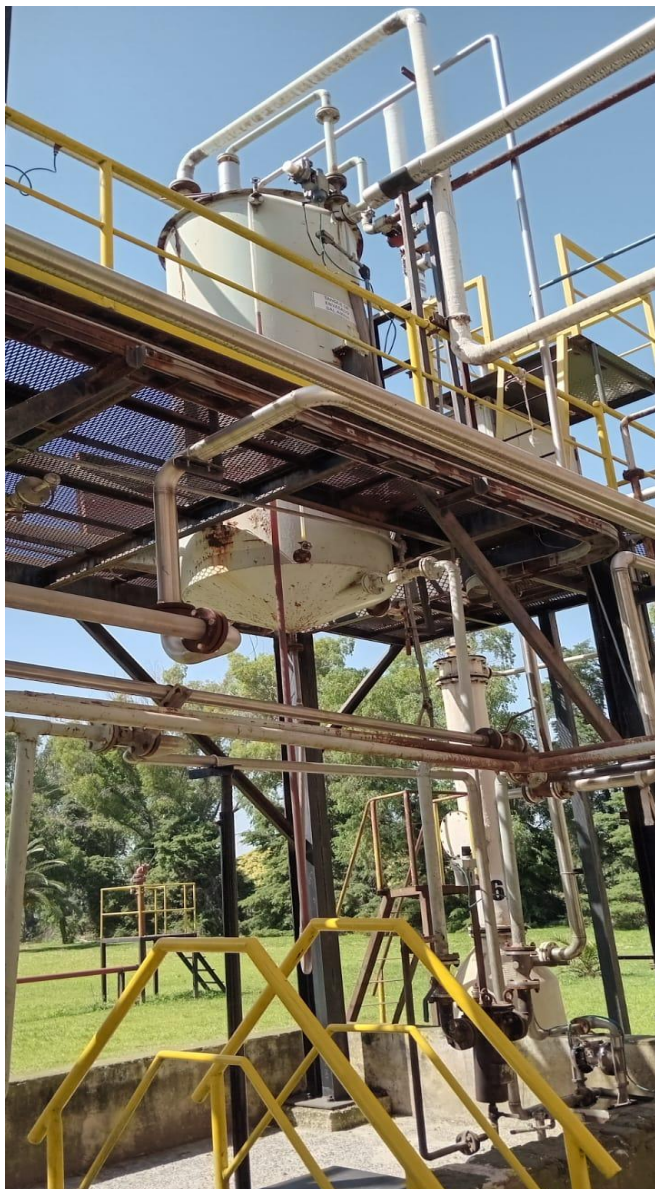
Tanque de sal amina vaciando
