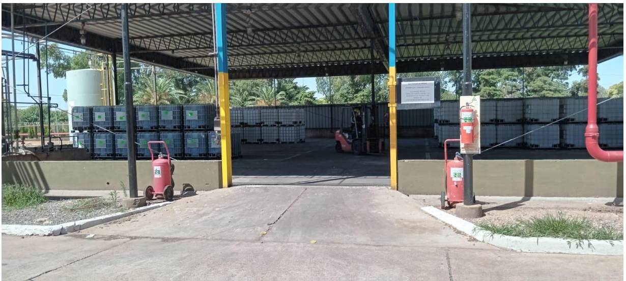
Deposito de Producto terminado extraído de tanques
