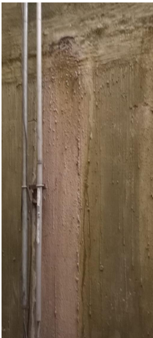
FILTRACION DE PARED EN ZONA INTERIOR DE CAMARA DE AFORO
