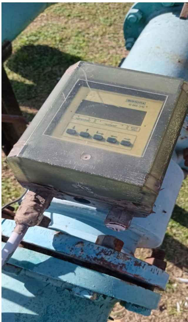
CAUDALIMETRO EN POZO DE EXTRACCION DE AGUA N° 6
