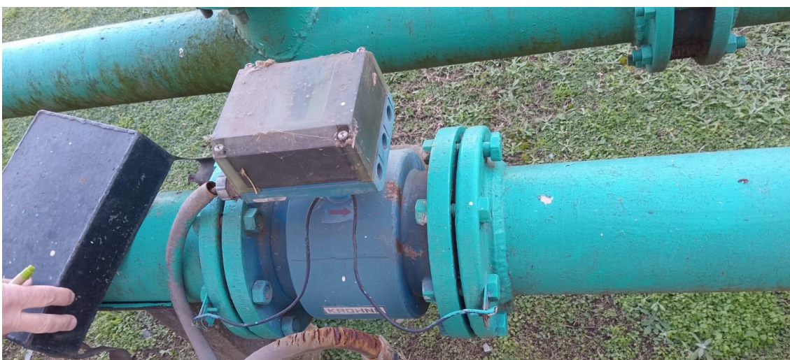
CAUDALIMETRO EN POZO DE EXTRACCION DE AGUA N° 8
