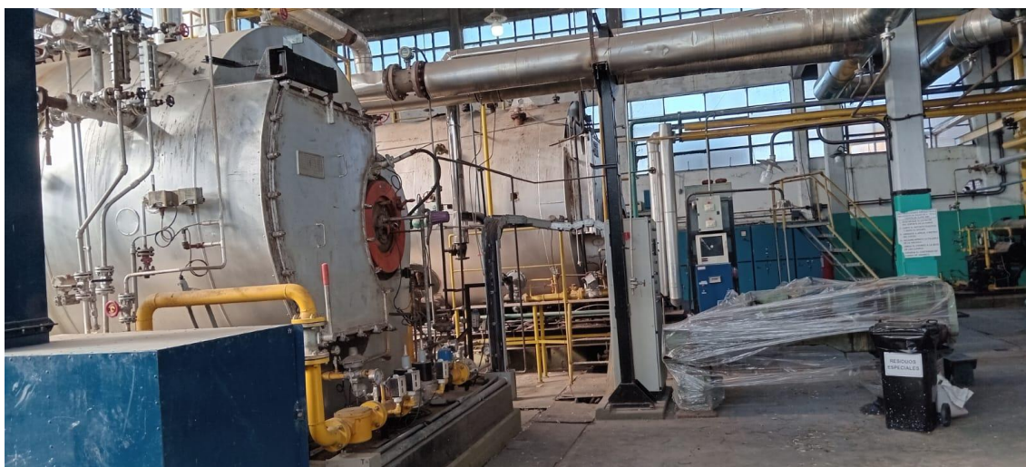
SALA DE CALDERAS
