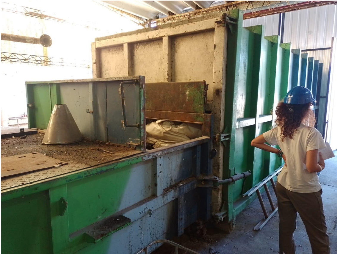
Ilustración 20: compactadora del sector transitorio de residuos especiales
